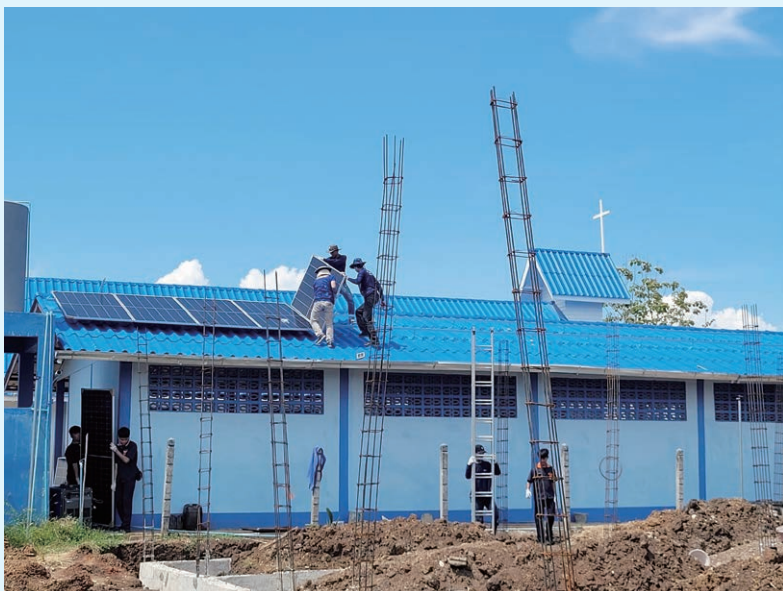
小學部新課室已安裝太陽能設備，供應學校電力。
